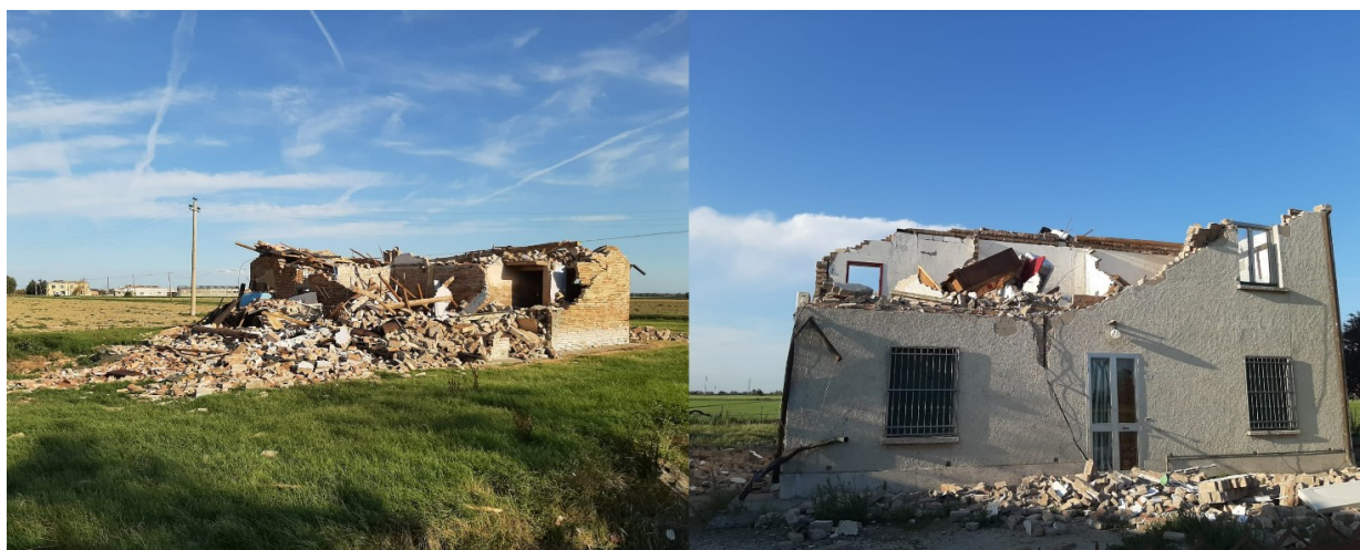
Figura 2. Danni ad est di Voltana documentati da Mattia Palombo (Emilia Romagna Meteo), valutabili come di grado F3
